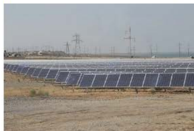
(б) Гелиоэлектростанция. Сумгайыт.
